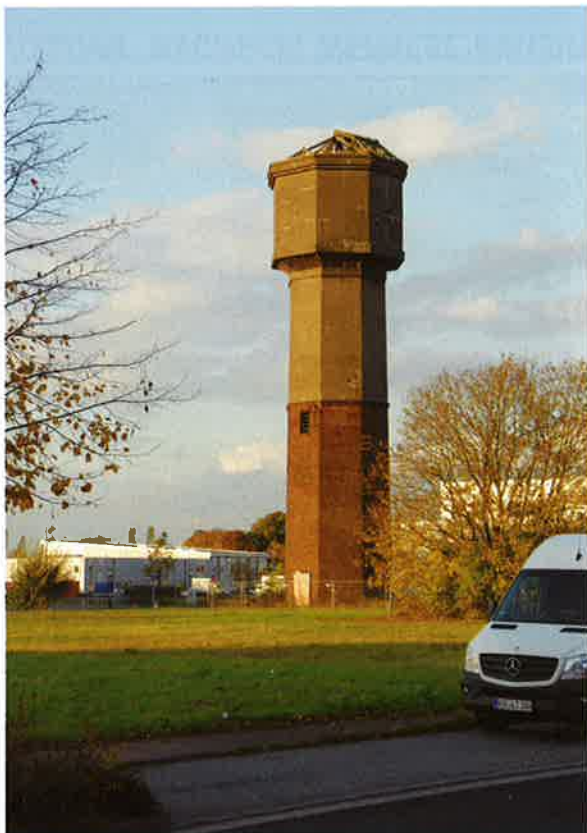
Noch nicht akut gefährdet: Der Wasserturm im Stahlwerk Becker, dessen Dach auch nur noch in Teilen vorhanden ist.
