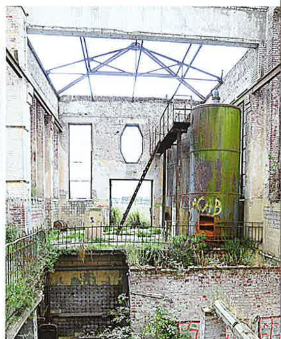
Das recht grüne Innenleben: Von Dach kann keine Rede mehr sein.
